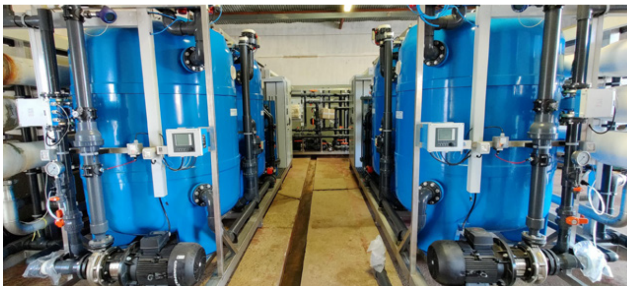
Unité de désalinisation de Ponta Preta sur l'île de Maio au Cabo Verde
